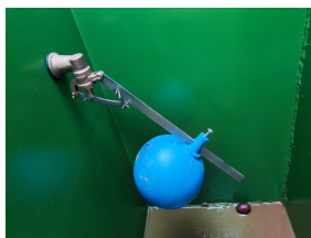
Flotador para mantener el nivel del agua
